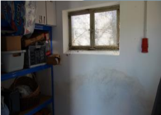
Stockflecken und Feuchtigkeit im Gebäude
